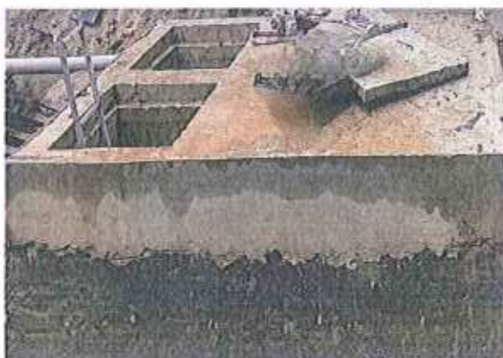
Hình ảnh bể gom
