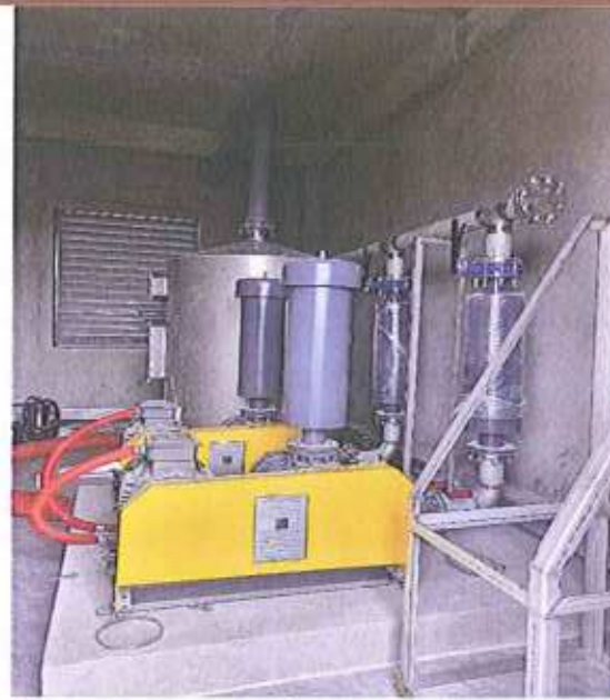
Nhà đặt máy thổi khí và HTXL mùi
