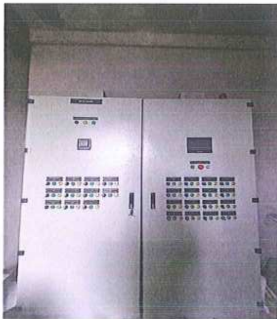
Tủ điện điều khiển
